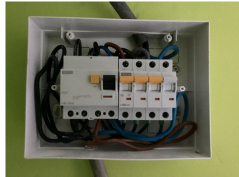
( Elektrisch bord - binnenkant )
